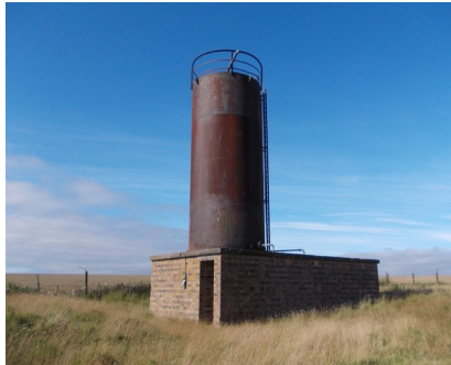
Figura 7.1 Tanc de combustible
