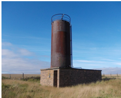
Figura 6 Tanc de combustible
