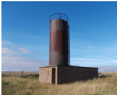
Figura 7.8 Tanc de combustible
