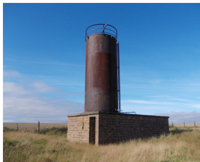
Figura 65 Tanc de combustible
